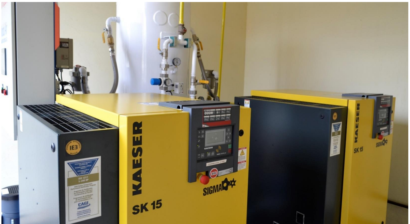
Figura 1 - Novo Sistema de Ar Comprimido e Sistema de Vácuo | Fotografia e Texto: Nathan Cruz - Comunicação HERSO/IPGSE
